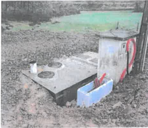
FOTO 4 - FECHO DE SISTEMAS DE ÁGUAS RESIDUAIS EM VÁRIOS LUGARES DOS MUNICÍPIOS DE MURÇA E SABROSA
