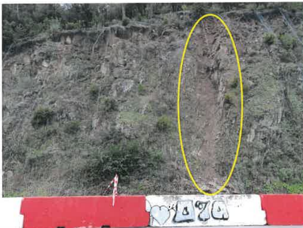
Fotografia 4 – Escorregamento em cunha ocorrido em toda a altura do talude de escavação, com deposição do material escorregado na base
