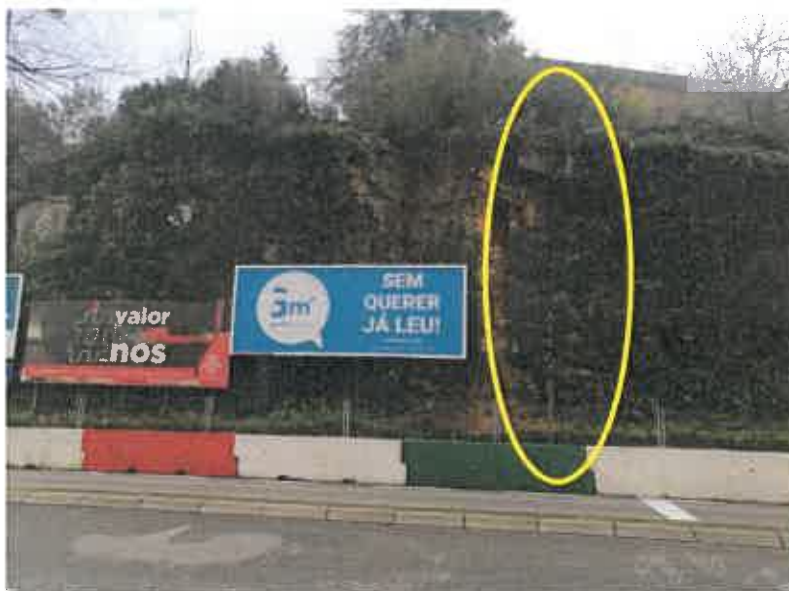
Fotografia 2 – Vista geral da cicatriz da cunha de escorregamento do talude de escavação que afetou toda a altura do talude
