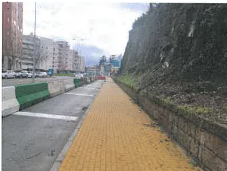
Fotografia 6 – Vista geral da interdição da via direita à circulação de viaturas e da interdição do passeio à circulação de pessoas
