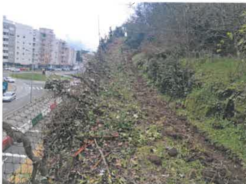
Fotografia 7 – Vista geral do topo do talude de escavação no local do escorregamento – acesso facultado gentilmente pelo proprietário do terreno com o apoio da CMVR
