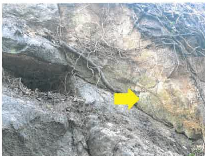
Fotografia 5 – Proliferação de raízes pelo interior de descontinuidades do maciço rochoso do talude de escavação
