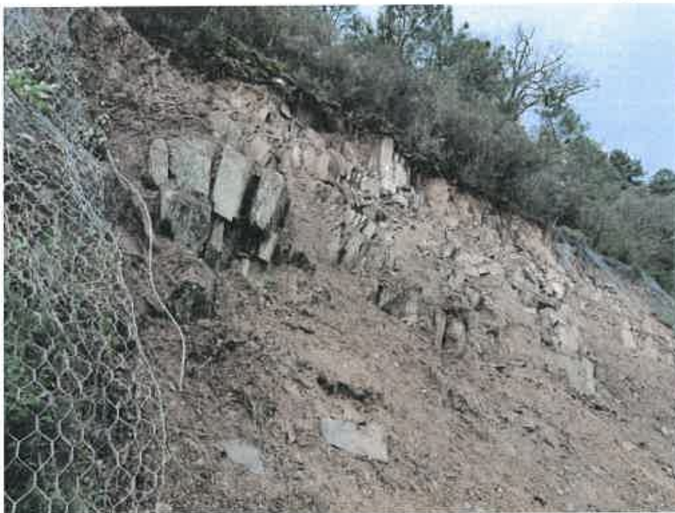
Fotografia 3 – Pormenor de blocos rochosos soltos na área de escorregamento do talude de escavação
