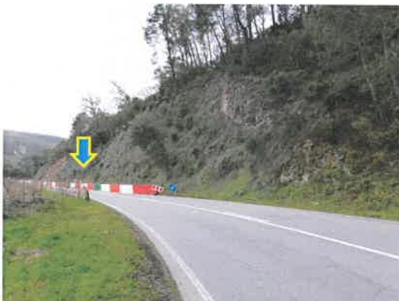
Fotografia 1 – Vista geral do talude de escavação em estudo com a indicação da zona de escorregamento ao fundo
