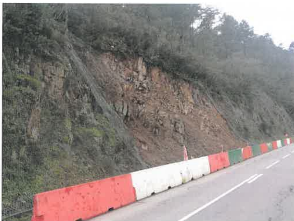
Fotografia 2 – Vista geral da área de escorregamento do talude de escavação que afetou toda a altura do talude
