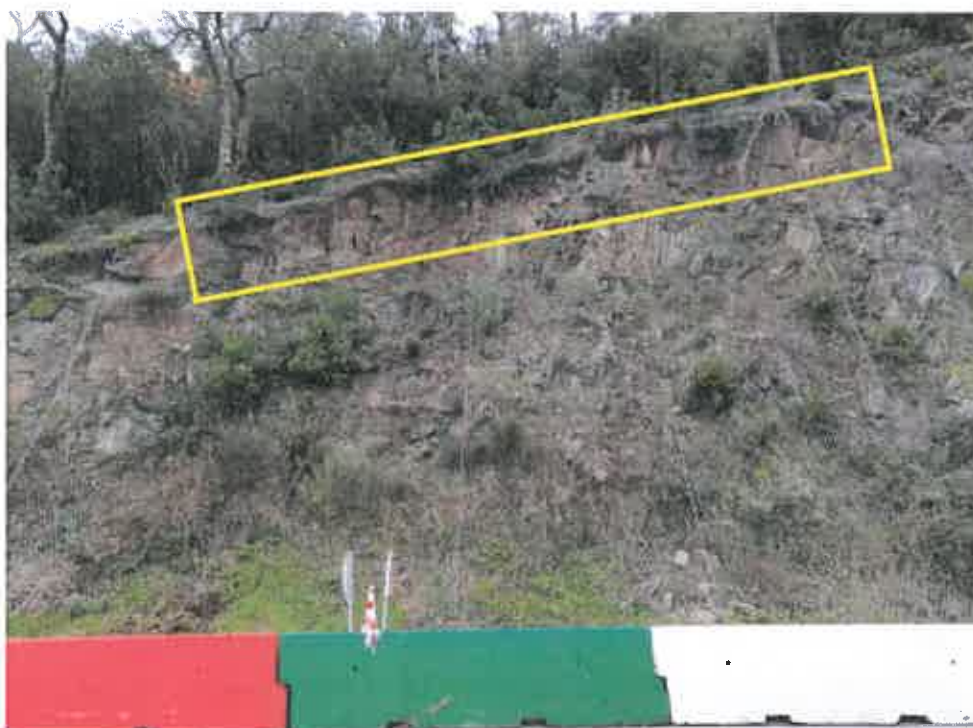
Fotografia 6 – Presença de material rochoso descomprimido no topo do talude de escavação
