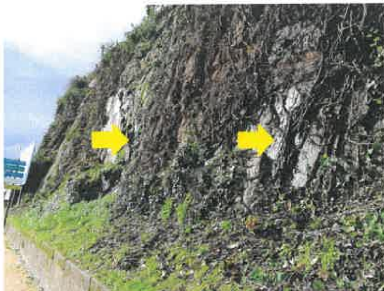
Fotografia 8 – Evidências de percolação de água patentes em vários locais na face do talude de escavação
