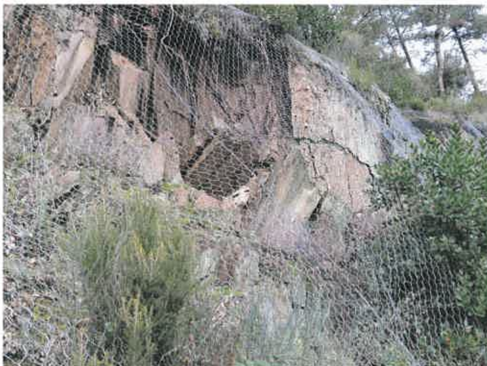
Fotografia 5 – Pormenor de blocos rochosos descomprimidos/soltos no topo do talude de escavação
