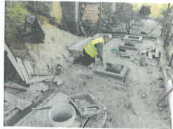
Foto 1 - Remodelação de ETAR's e EEAR's nos Municípios do Núcleo Douro e Corgo
