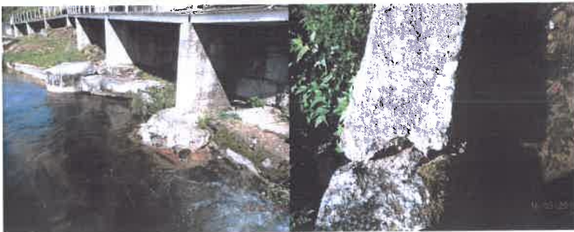
Fotografia 12 e 13 – Muros de Suporte com elementos a reforçar.
